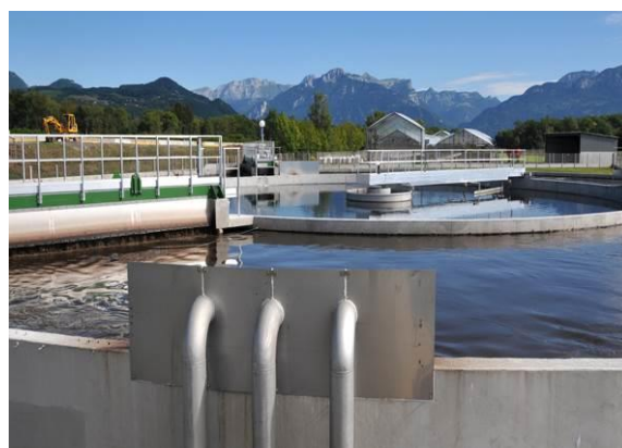
La station d'épuration de Bellecombe
