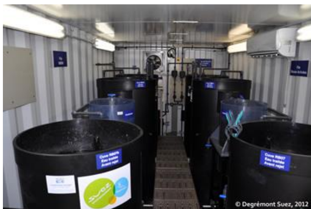
Pilotes de traitement Degrémont Suez installés à la STEP de Bellecombe
