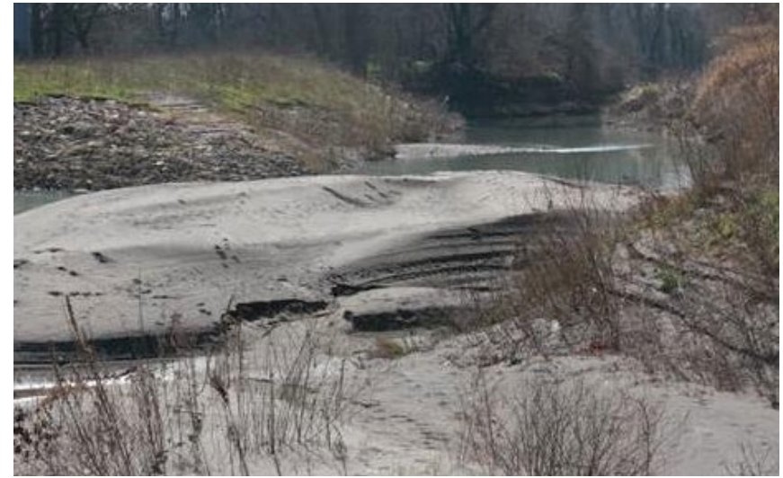
Dépôts dans le RCC suite à la chasse de la basse Isère (2021)
