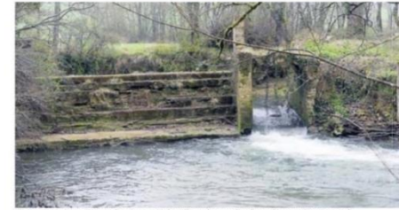
Une vanne automatique mécanique est très utile sur les moulins à eau. Pourquoi tout casser?
