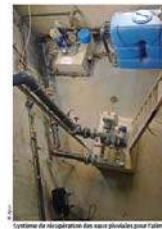
Système de récupération des eaux pluviales pour l'alimentation des toilettes. Photographie de Paris, Paris 11 e
