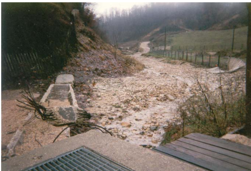
Photo prise en 1995 suite aux violents orages : entrée du piège à limons en aval du torrent de Panerel (source : Burgeap)
