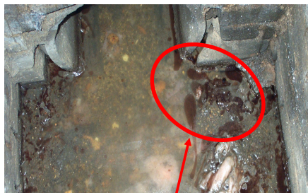
Traces de fioul
