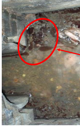
Traces de fioul
