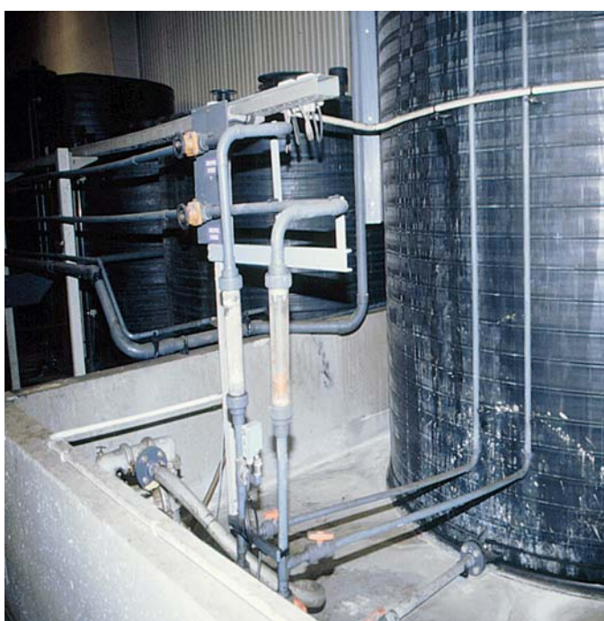
Figure 8. Exemple de stockage avec rétention.
