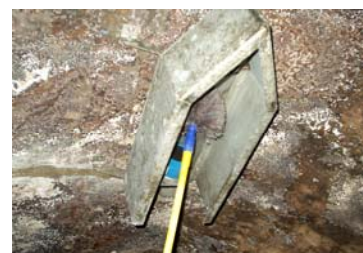
Illust. 3: nettoyage d'une sonde installée en voûte (Photo Exploitation Métrologie - Grand Lyon)
