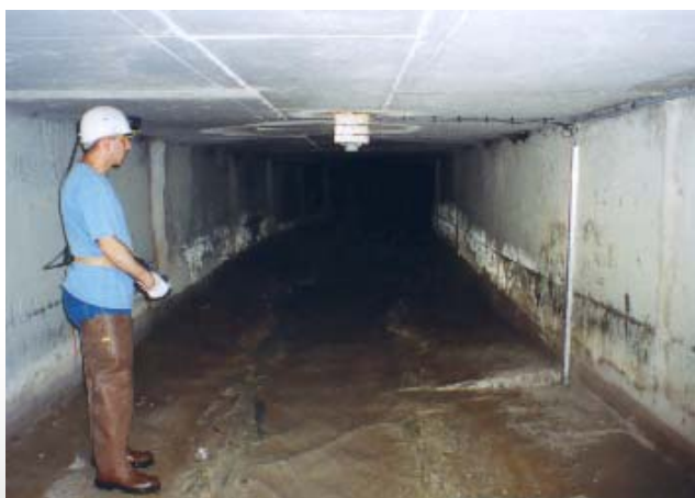
Illust. 1: Exemple d'installation d'un capteur à US sous la voûte d'un collecteur sans renvoi d'angle (Photo Direction de l'eau et de l'assainissement de la ville de Marseille – SERAM)
