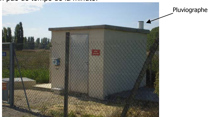
Illust. 4: Exemple d'installation d'un Pluviographe à augets basculants installé au niveau d'un poste de relèvement (Photo SIARP, Portes les Valence)
