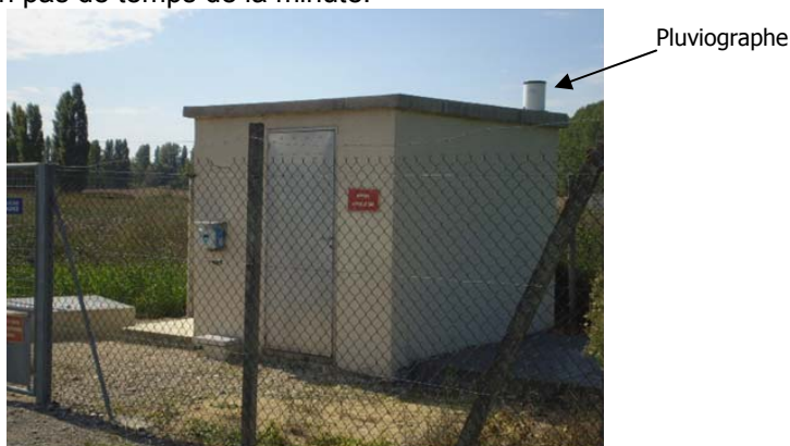
Illust. 4: Exemple d'installation d'un Pluviographe à augets basculants installé au niveau d'un poste de relèvement (Photo SIARP, Portes les Valence)
