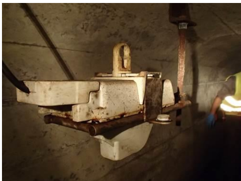
Illust. 1: Exemple d'installation en réseau système compact (Photo OTHU- Site expérimental Ecully)
