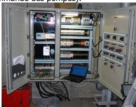
Illust. 1: Équipements de mesure et de télégestion d'une station de pompage, Ville de Mâcon
