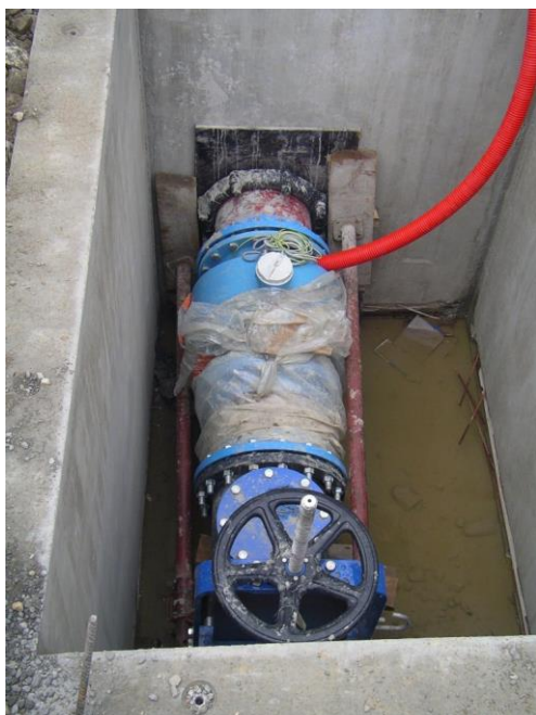
Illust. 1: Exemple d'installation en réseau (Photo Chambéry métropole)
