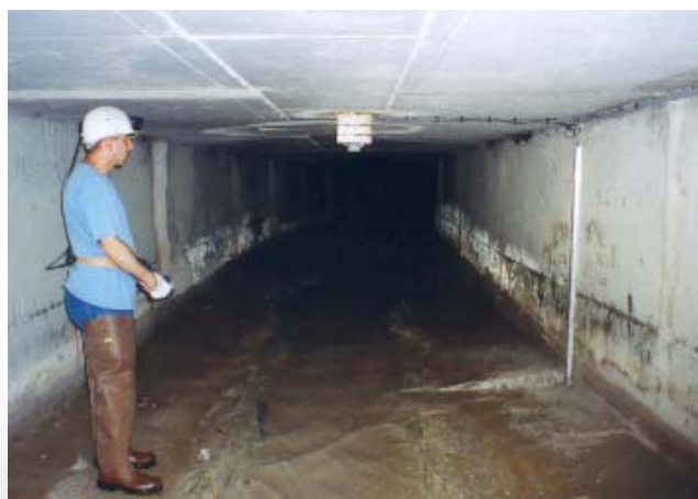
Illust. 1: Exemple d'installation d'un capteur à US sous la voûte d'un collecteur sans renvoi d'angle (Photo Direction de l'eau et de l'assainissement de la ville de Marseille – SERAM)
