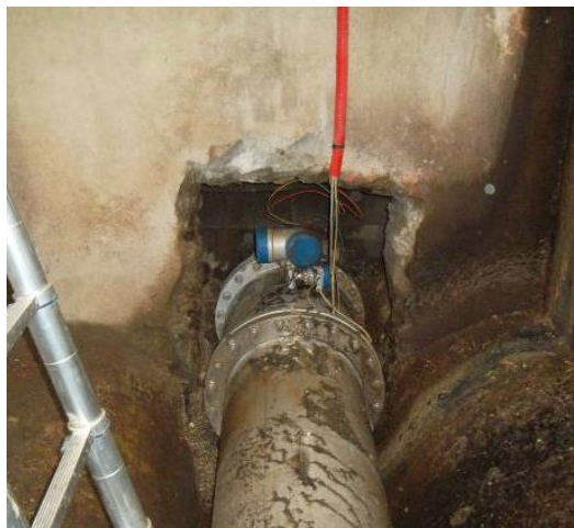
Illust. 2 Exemple d'installation dans une chambre de comptage – Romans-sur-Isère
