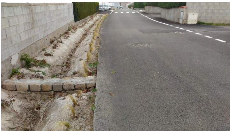
Vue générale de la noue et la voirie. Le massif drainant s'étend sous voirie là où s'arrête la noue.
