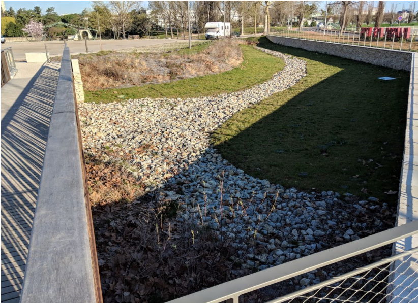
Photo d'un bassin sec, exutoire des tranchés drainantes
