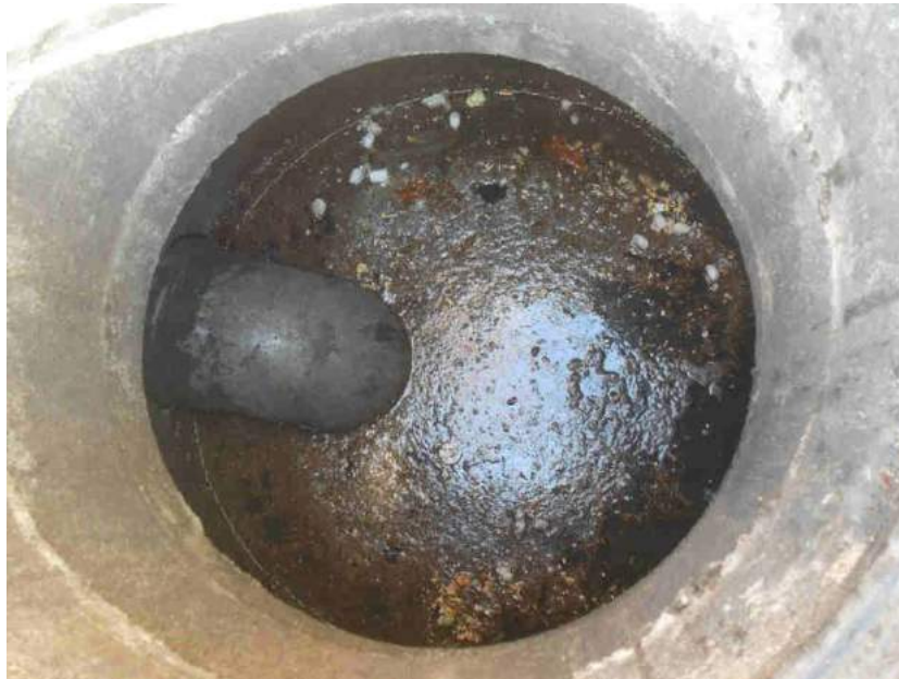
Regard siphonide et décantation
