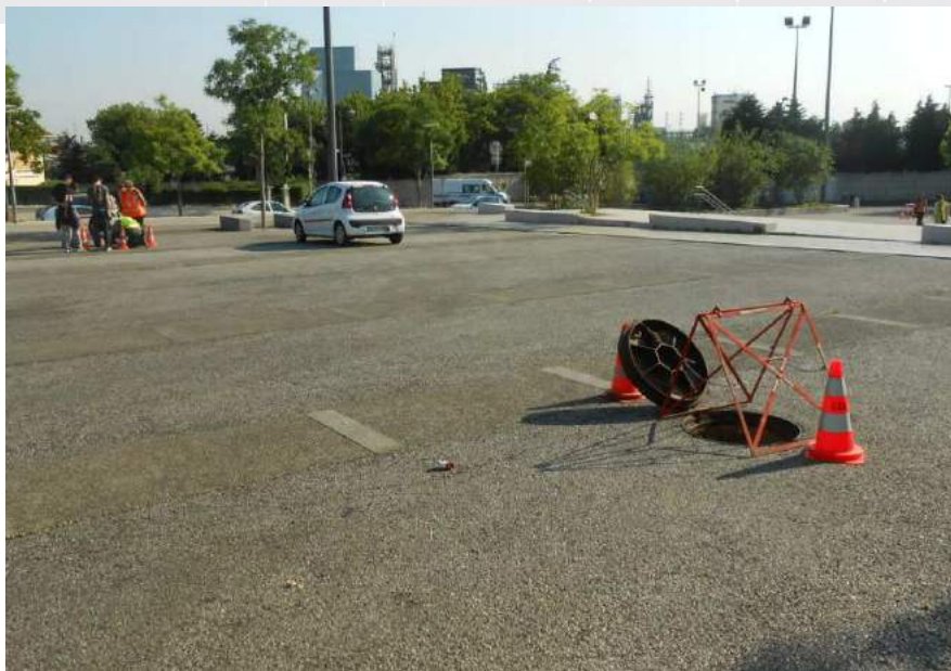
Regard de contrôle du bassin
