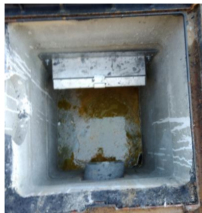
Regard décanteur et filtre adopta sous une grille avaloir récoltant les eaux de voirie
