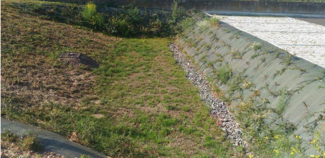
Vue du bassin, avec la surverse vers les eaux pluviales
