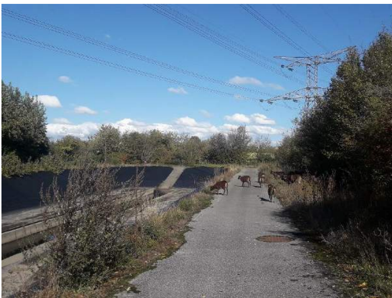
A gauche le bassin de rétention avec géomembrane, à droite les moutons lors de l'installation
