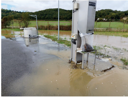
Photo de Sylvain Devidal, Vienne Condrieu Agglomération. « Inondation poste de relevage »
