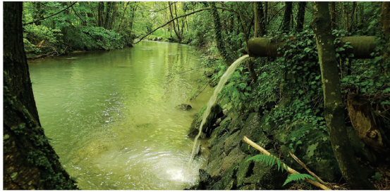
Photo de Sylvain Devidal, Vienne Condrieu Agglomération. « Rejet DO »
