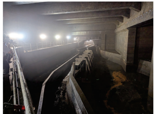
Photo de Frédéric Cherqui, INSA, prise en juin 2023 à Lausanne, Suisse. « Le déversoir « Le Capelard » a été construit en 2012 est équipé d'un dégrilleur d'une longueur de 18 mètres de long. »
